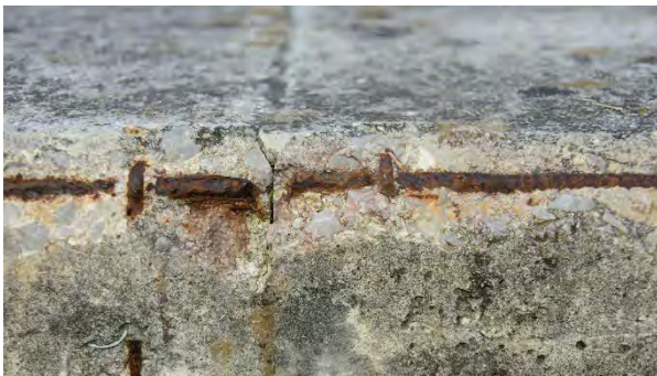
Abbildung 1: Folgen der Bewehrungskorrosion
